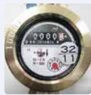
水道メーター写真
