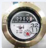
水道メーター写真
